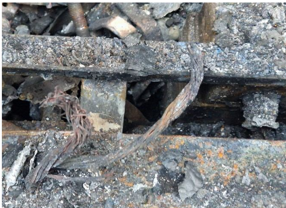
Фиг. 4.11. Изглед на захранващите кабели на двигател компресор
